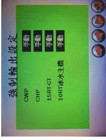
該頁次設定 CWP、CHP、CT 及冰水主機的手/自動選擇。
